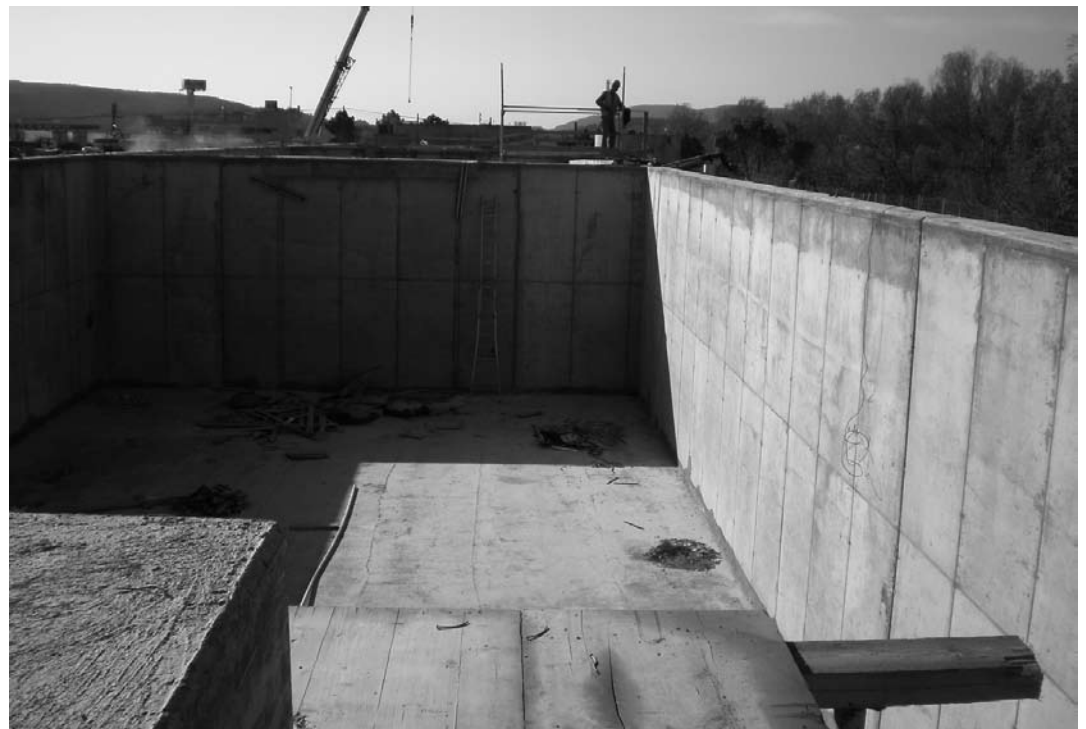
• Estat actual de les obres de la nova depuradora de la Jonquera (Foto Esquerda)
