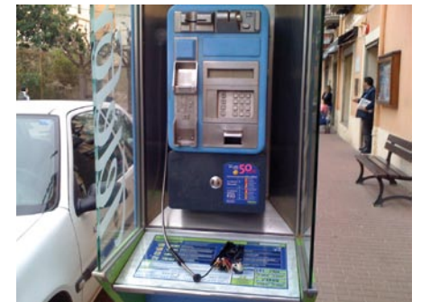
• L'aparell telefònic de la cabina del carrer Major està inutilitzat
