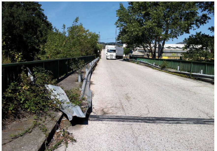
• Estat actual que presenta el pont sobre el riu Llobregat a la "unidireccional" (Foto particular)
