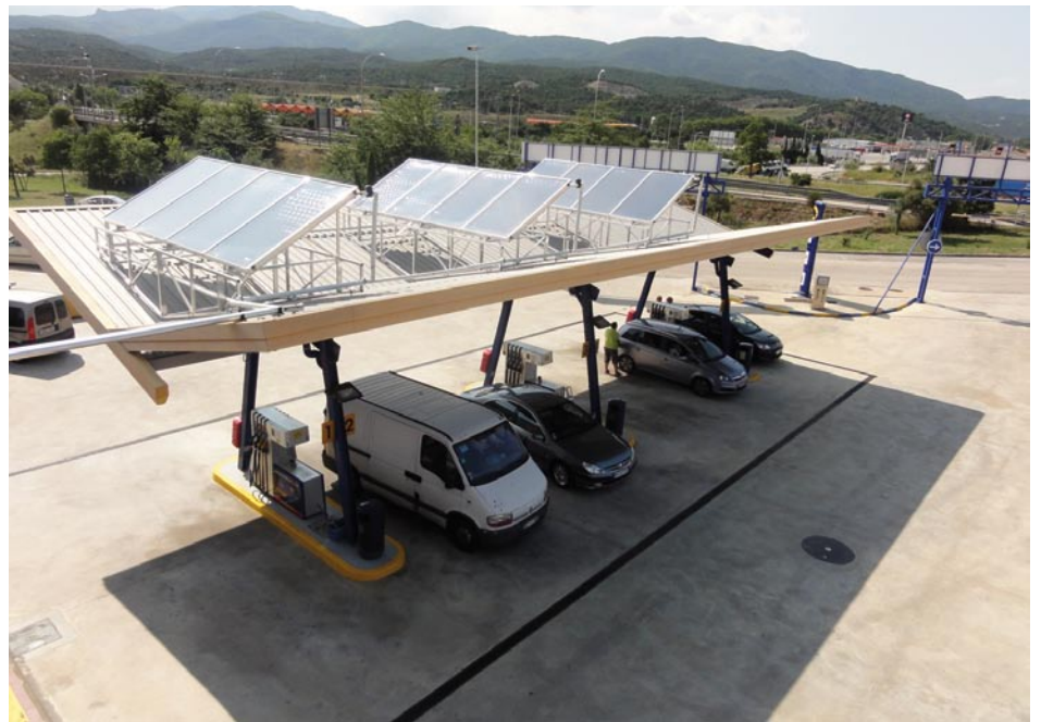
• Les plaques solars s'han situat sobre la marquesina de l'estació de servei destinada a vehicles lleugers (F. RT).
