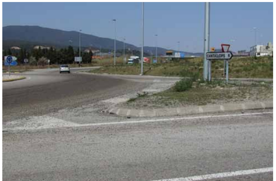
• Rotonda de Can Quartos: la línia discontinua que indica el centre de la rotonda ja no existeix. La grava dels vorals no es retira gairebé mai. Els pneumàtics dels camions i el gasoil que de tant en tant vessen creen una capa de greix al centre dels vials. (F. Infojonquera.cat)
