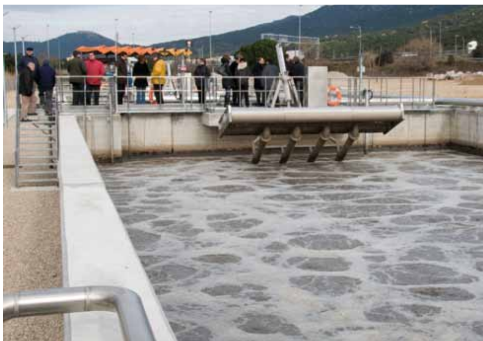
• Depuradora actual, inaugurada l'hivern de 2009. S'han acabat els problemes de depuració deficientes i els vessaments. (Arxiu J. Ribas)
